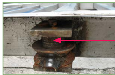
閘門底部裝置的滑輪出現生銹，導致不能轉動
