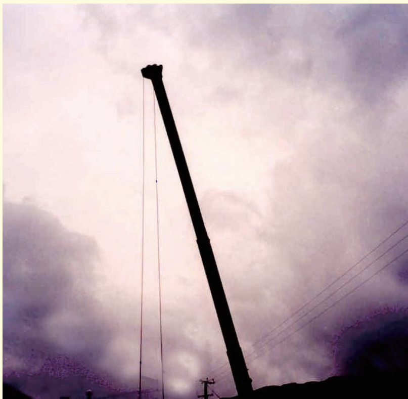
起重機吊臂在架空電纜鄰近範圍內移動
