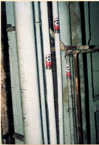
鍋爐及喉管隔熱材料
