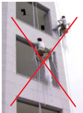
香港法例禁制使用的工作吊板
