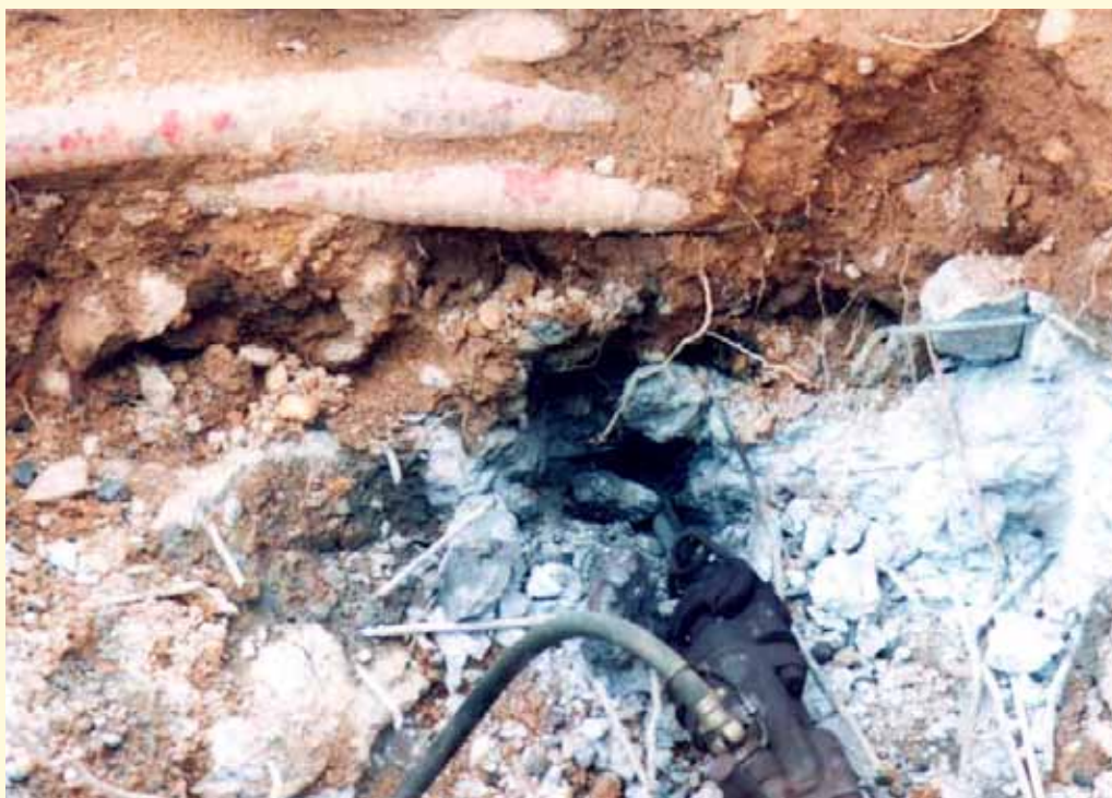
在进行挖掘前没有确定地下电缆位置，暂停其电力输送及采取适当安全措施
