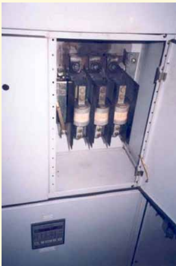
在掣柜内进行度尺引起短路
