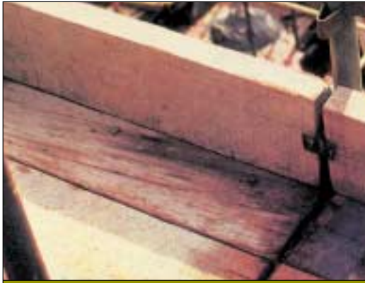
双行金属棚架的工作平台应设有护栏、底护板及以木板铺密*。
