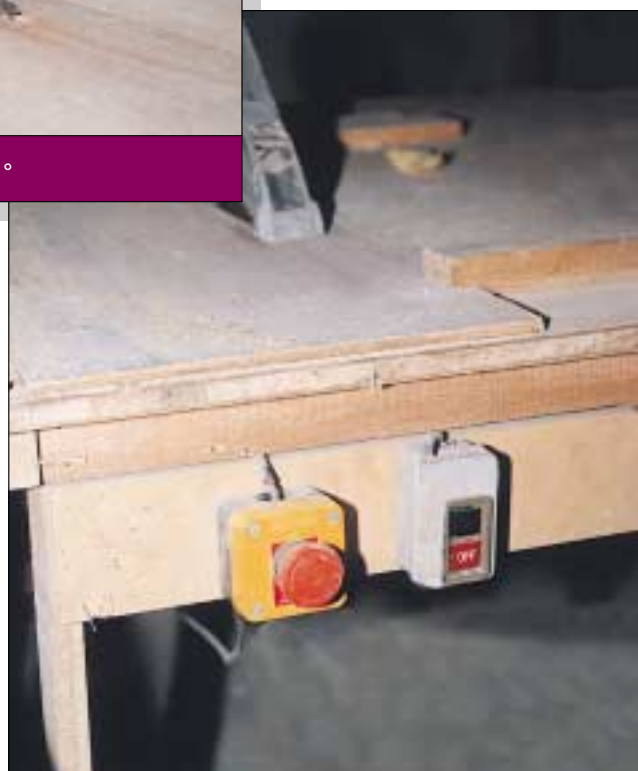
风车锯应设有有效开关掣及紧急停机装置。
