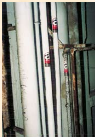
锅炉及喉管隔热材料
